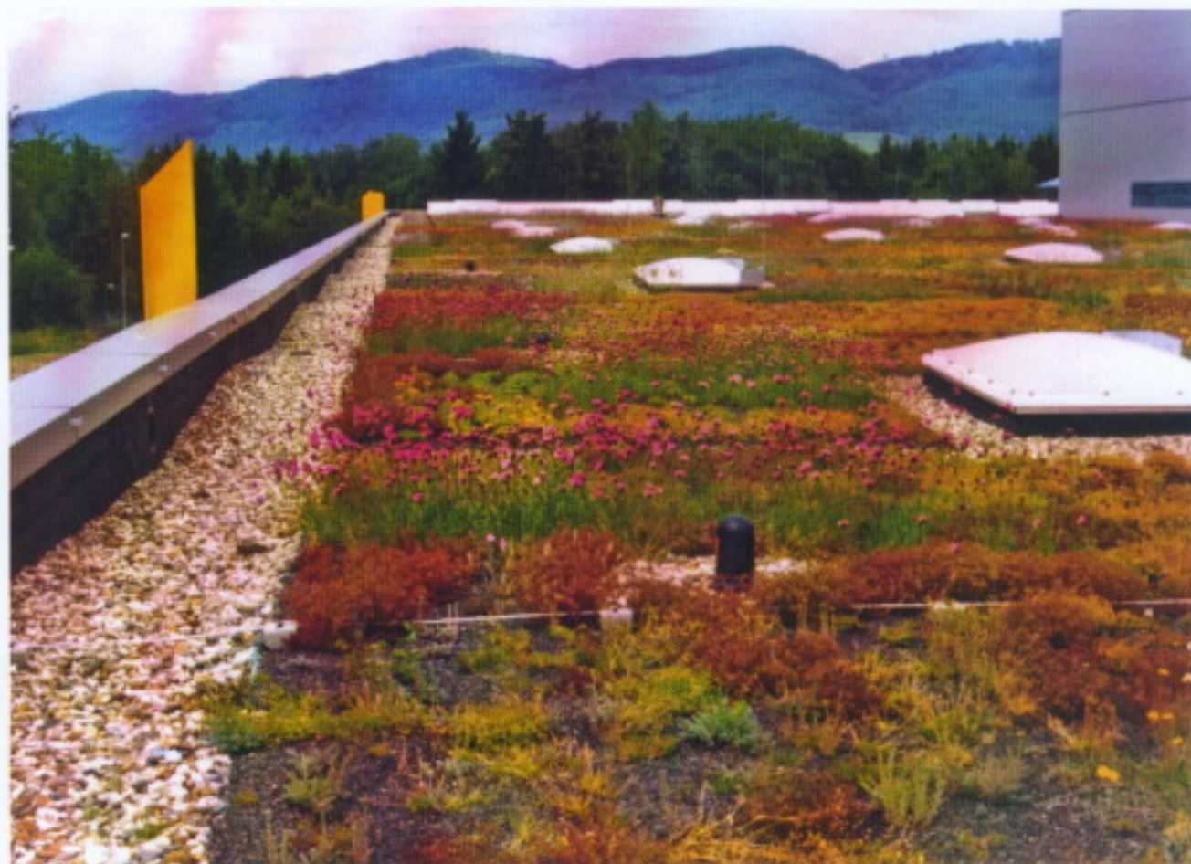
Einfach mal Gras drüber wachsen lassen. So schön kann ein Flachdach sein.
