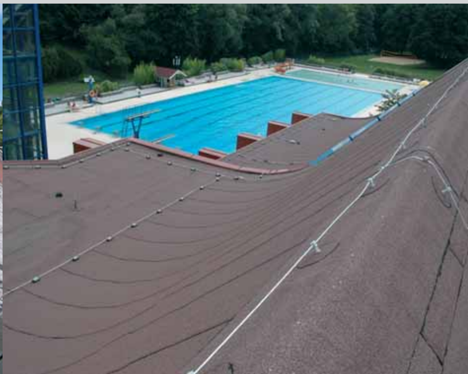
Bei der Dachsanierung wurden die Bahnen zur Reduzierung der Kopfstöße und aus optischen Gründen in Fixlängen aufgebracht.
